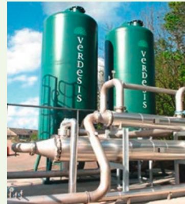
La station d'épuration des eaux urbaines de la Grange David à La Riche.
