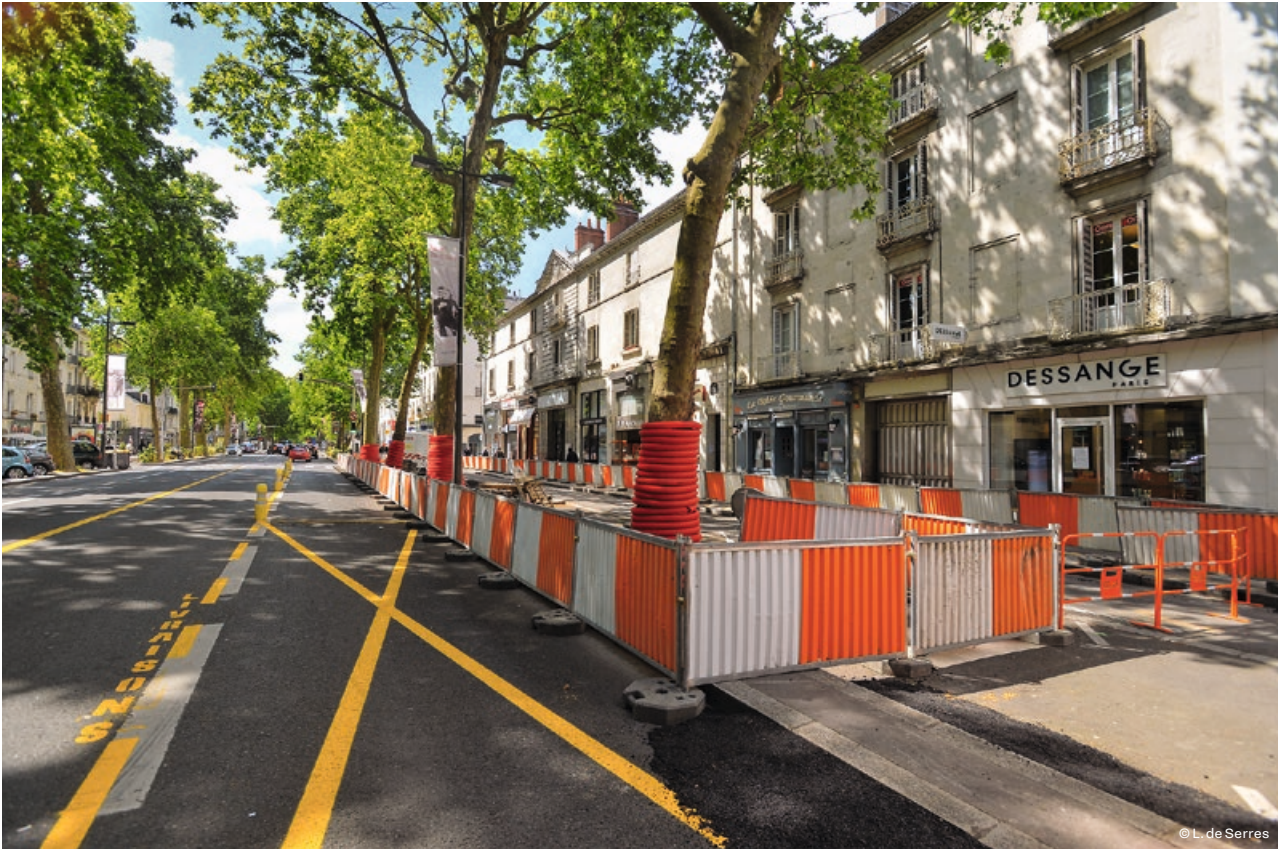
Le chantier de redynamisation de l'avenue de Grammont à Tours s'est déroulé en deux phases, entre 2019 et 2020.
