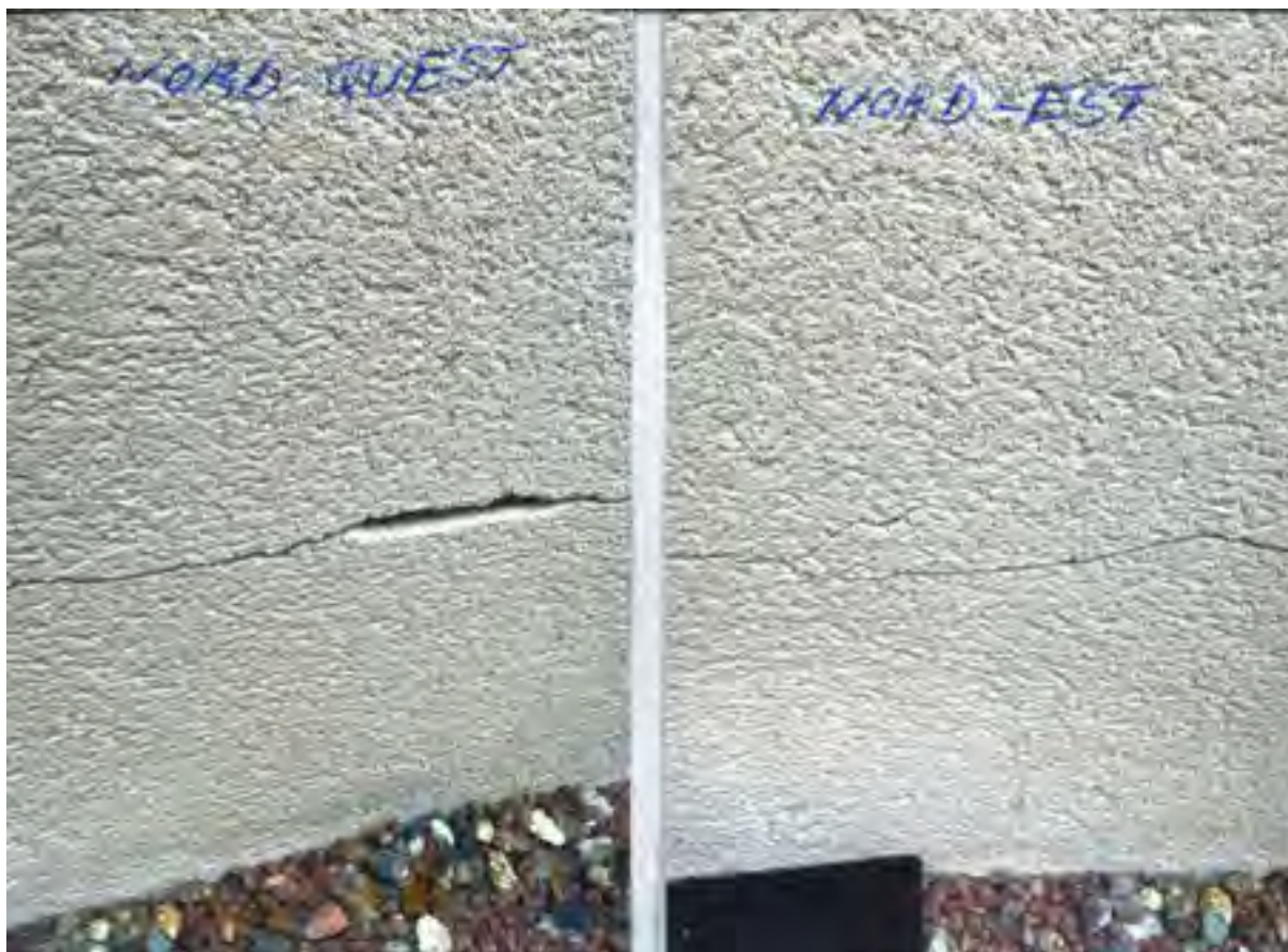
Figure 68 : Maisons fissurées par le retrait et gonflement des argiles (Commune de Mettray, 2022)
