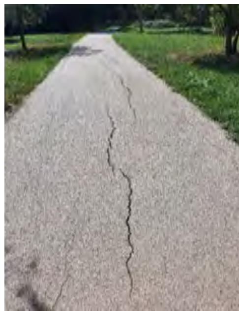
Figure 76 : Fissures dans la chaussée de la piste cyclable, près du petit Cher (Tours, 2022)
