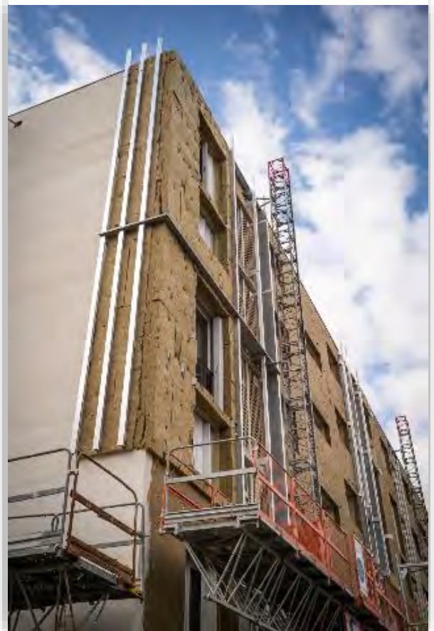
Figure 81 : Chantier de rénovation thermique d'un immeuble rue Saint-Barthélémy, à Tours, en août 2021 (© François Lafitte, Ville de Tours)
