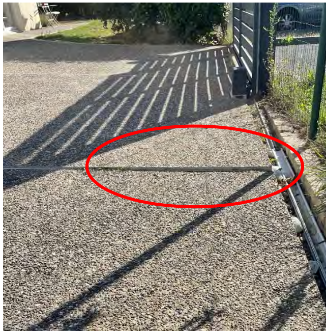
Figure 75 : Dalle déchaussée par le gonflement/retrait des argiles (Commune de Mettray, 2022)
