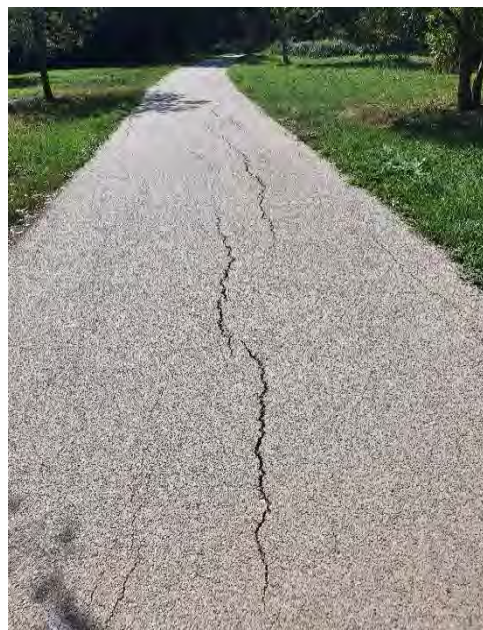
Figure 76 : Fissures dans la chaussée de la piste cyclable, près du petit Cher (Tours, 2022)
