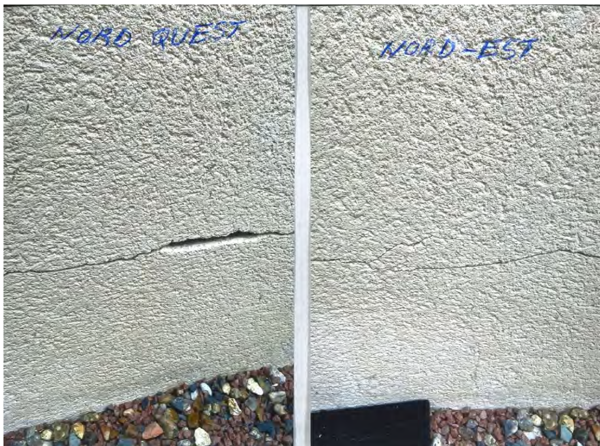
Figure 68 : Maisons fissurées par le retrait et gonflement des argiles (Commune de Mettray, 2022)
