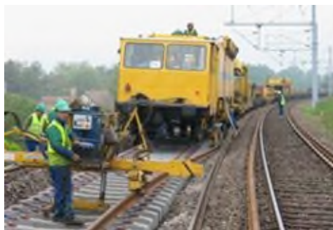
Longs Rails soudés sur traverses béton
